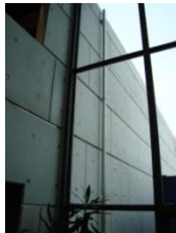
Detalje af stød mellem facadedelene.
