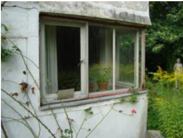
Revnedannelser over vinduet i børneværelset
