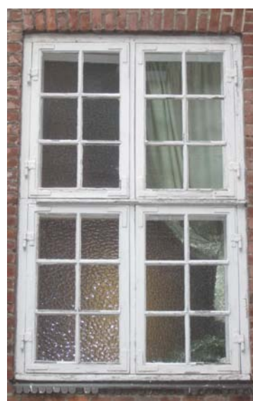
Et af de oprindelige vinduer i hovedbygningen. Bemærk sålbænk af kobber.
