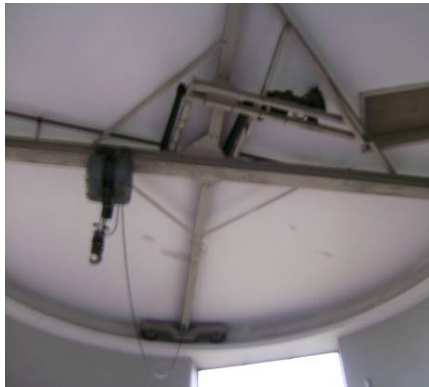
Traverskran i monteringsårnet
