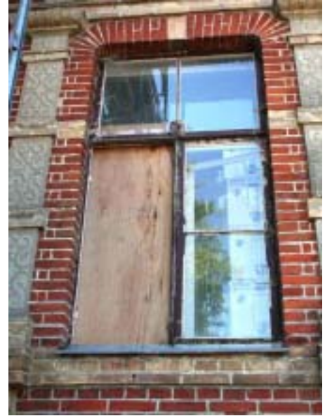
Vindue med restaureringsbehov.
